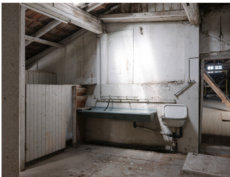
GAR NICHT EINLADEND: So sahen die sanitären Anlagen aus, die den rund 100 Saisonniers in Biel zur Verfügung standen.
